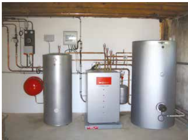
Pompe à chaleur géothermique reliée à un ballon tampon pour le chauffage et à un ballon d'eau chaude sanitaire.
