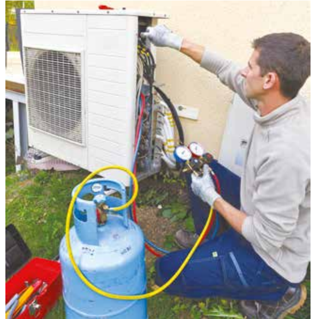
La pompe à chaleur doit être entretenue par un professionnel qualifié.
